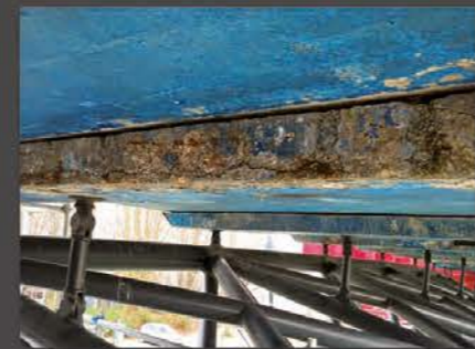
Ophélie ROUXEL La corrosion des aciers génère une importante fissuration de la poutre.
