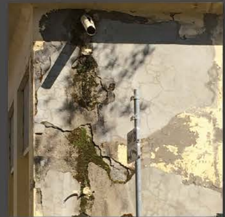
Medhi BOUSSOUNI Une mauvaise conception de l'évacuation des eaux pluviales a de fortes conséquences.
