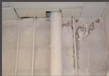
Camille PONS Dégradations liées à des fuites d'eau.
