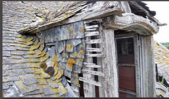
Ronan MOISAN Dégradation avancée d'une gerbière en raison d'une longue absence d'entretien.
