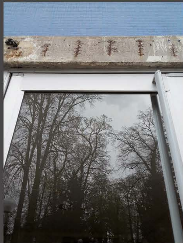
Premier Prix Svetlana PROMINSKAIA Épaufrures régulières sur une poutre en béton, les armatures étaient insuffisamment enrobées.
