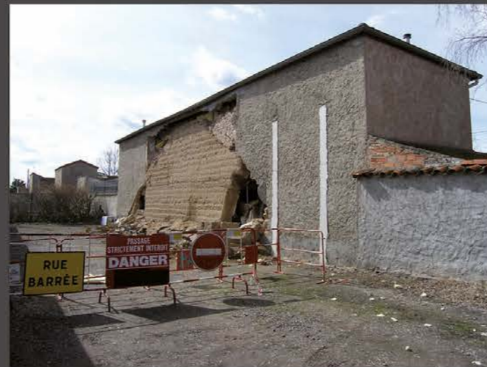
Deuxième Prix Antoine PERRIN L'enduit de façade a modifié l'équilibre hydrique du mur en pisé, entraînant sa ruine.
