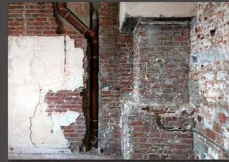
Anne VASSEUR L'encastrement des descentes a fragilisé le fonctionnement du mur porteur.
