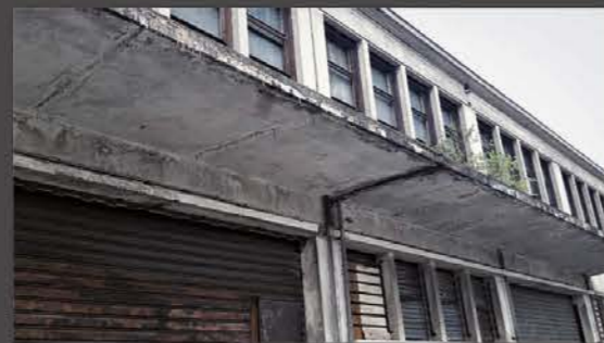
Inès LETEMPLE Casquette en béton, mal conçue, mal réalisée et non entretenue...
