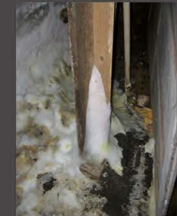
Simon MORVAN Développement de mэрule dans un sous-sol en terre battue.
