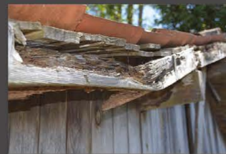
Alexandre DA SILVA Rupture d'une vieille poutre en bois.
