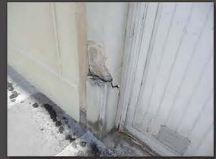
Enzo RAMON Rupture d'un poteau en béton, après un tassement du sol.
