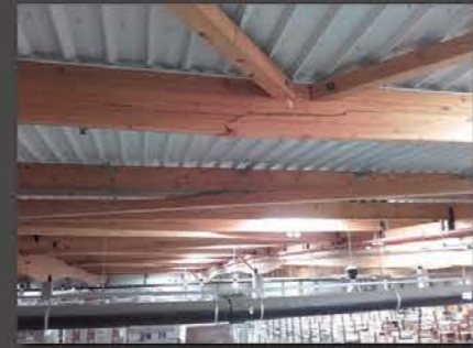
Paul JAHAN Rupture par délamination d'une poutre en lamellé-collé.
